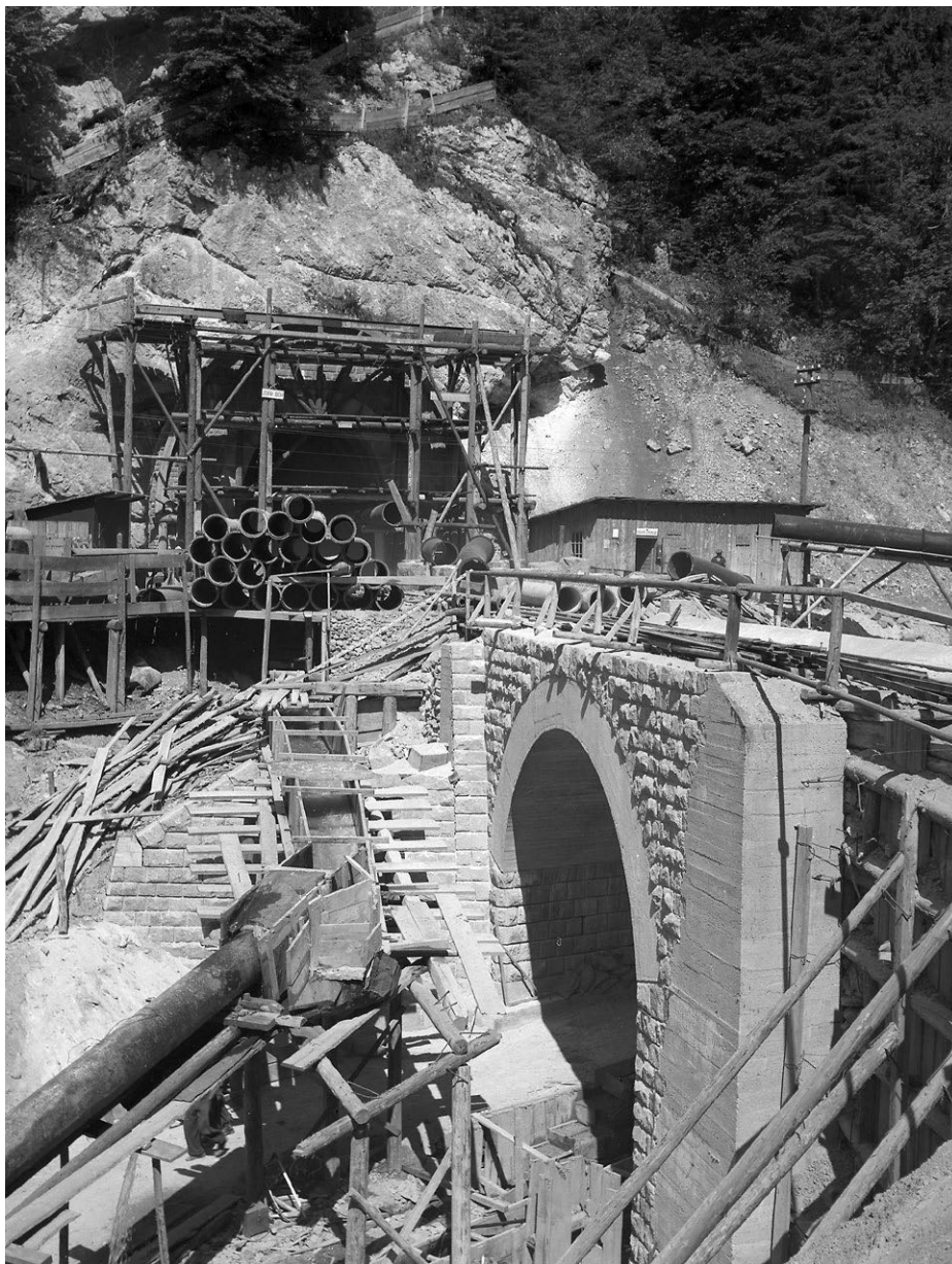
Stavba mostu na trati Banská Bystrica - Diviaky. Zdroj: SNA, f. STK, č. SK_1510_29443_02097.
