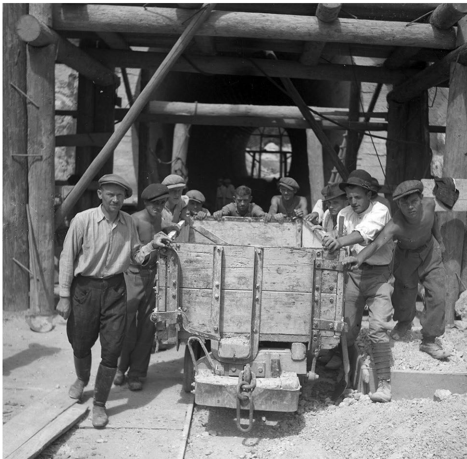
Ražba tunelu na trati Banská Bystrica - Diviaky. Zdroj: SNA, f. STK, č. SK_1510_29443_02097.
